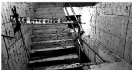
通道缺失：作業區未與工地有明顯隔離，通道散亂。
