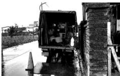
通道缺失：作業區未與工地有明顯隔離，通道散亂、視線不明，照明不足。
