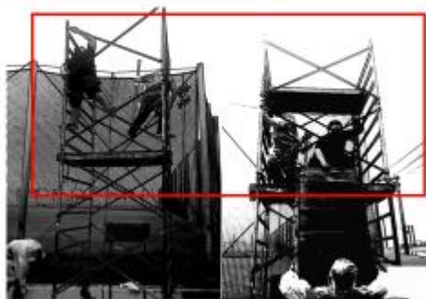
高處作業缺失：未做高處作業防護措施（護欄及安全網）、高台未做穩固措施。
